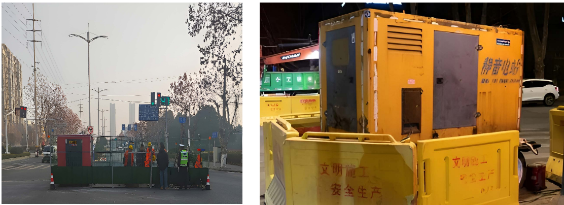
图 3-3 江苏省南京市某施工现场采用静音发电机
