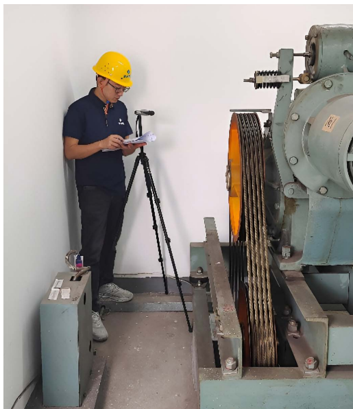
图 6-5 浙江省丽水市开展电梯机房内噪声检测
